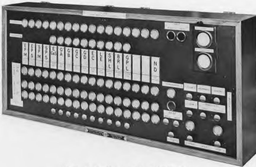
Fig. 5.—Up Local Retransmitter at Gidea Park.
